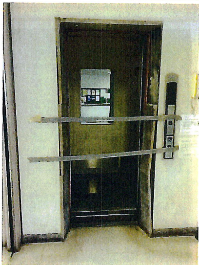
エレベーターの破損状況
