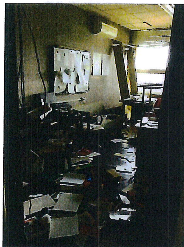
研究室の被災状況
