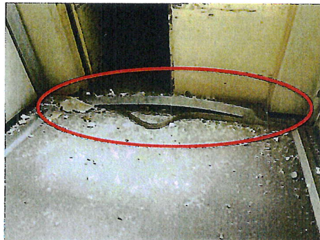
医学部臨床研究棟～旧管理棟 渡り廊下 エキスパンションジョイントの破損状況
