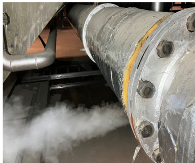
T-02 蒸気配管の破損
