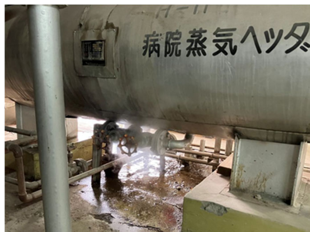
T-02 蒸気ヘッダーの破損
